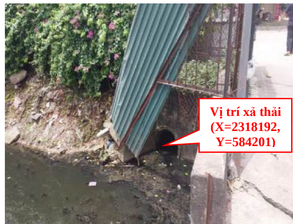
Điểm xả nước thải, nước mưa của cơ sở
