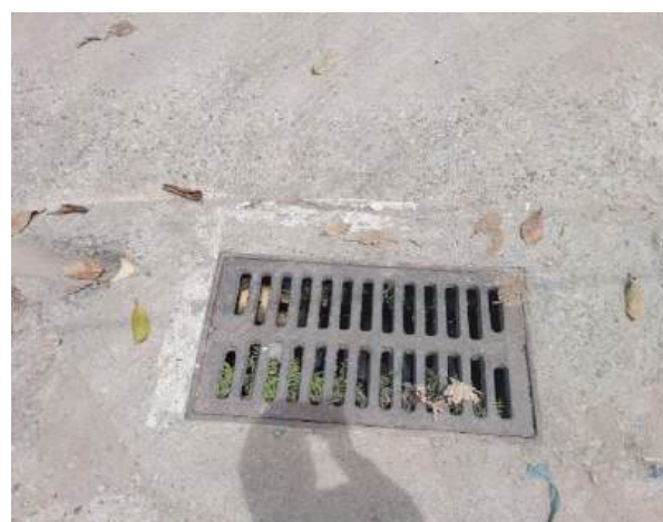
Hố ga thu nước mưa
