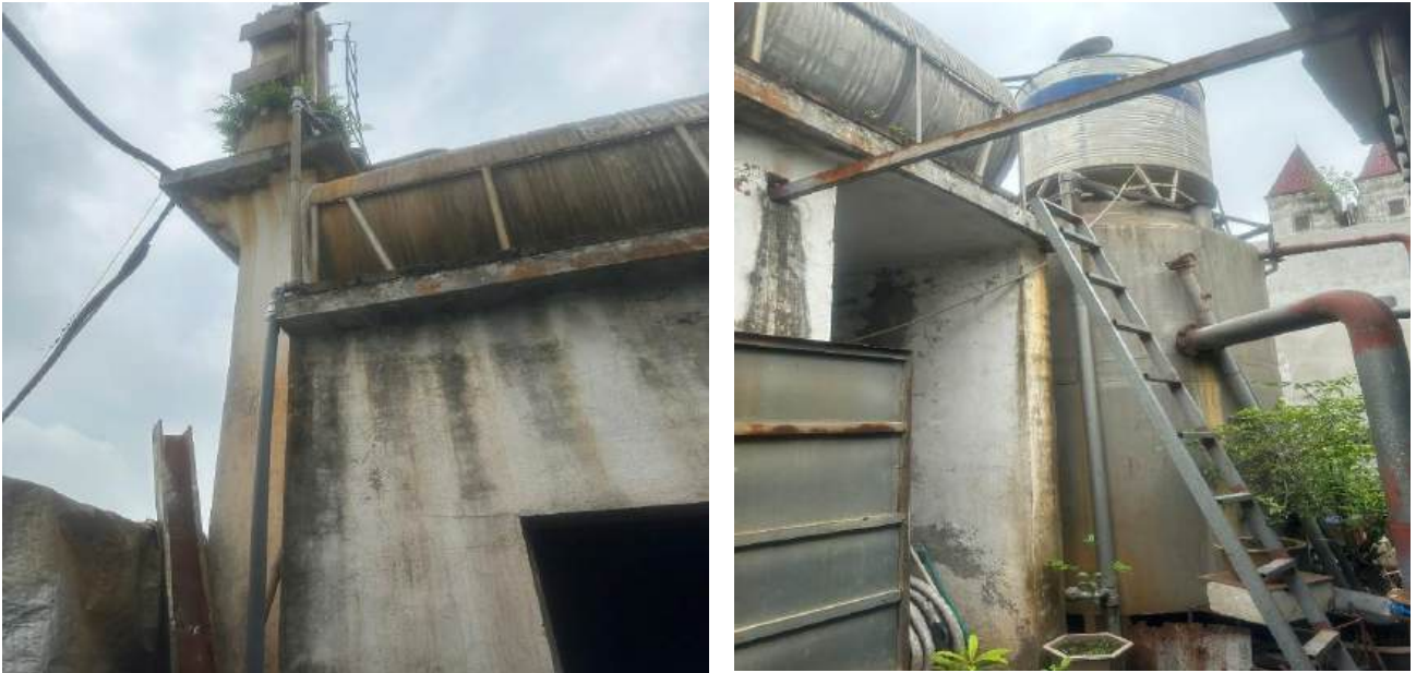
Hình 1. 4. Hệ thống lọc nước giếng khoan của cơ sở
